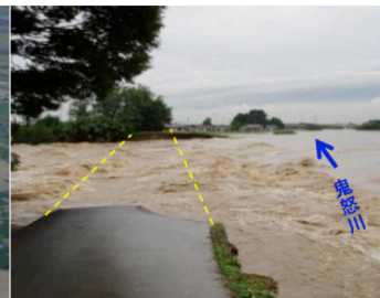
被災状況(拡大写真)
